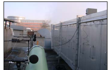
Messaufbau am Schalldämpfer der Siebpartie PM3
